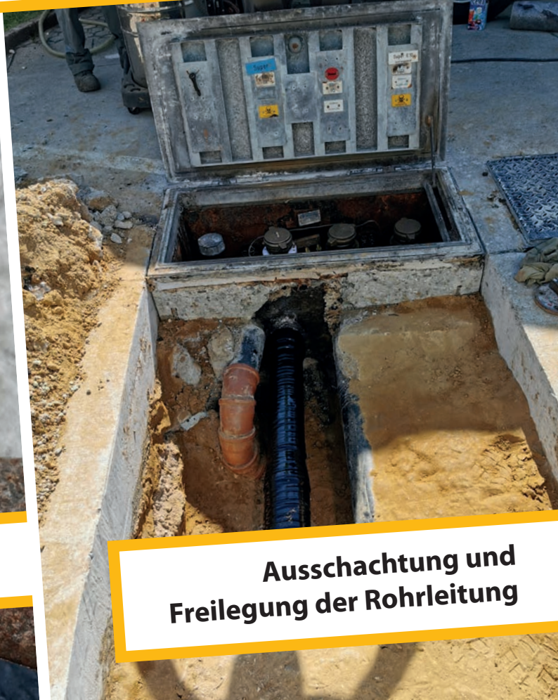
von Korrosion zerfressenes Rohr
