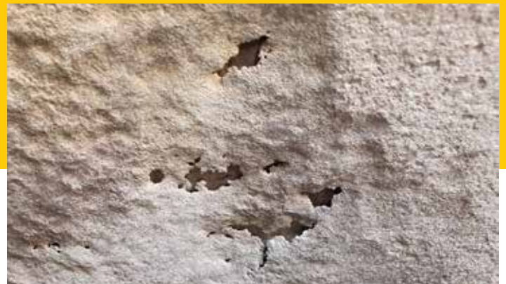
Schadhafte Stellen werden sichtbar: Lochfraß
