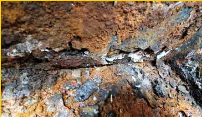
Starke Korrosion: Lochfraß im Schacht
